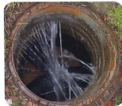
Grundwassereintritt im undichten Kanalschacht.
